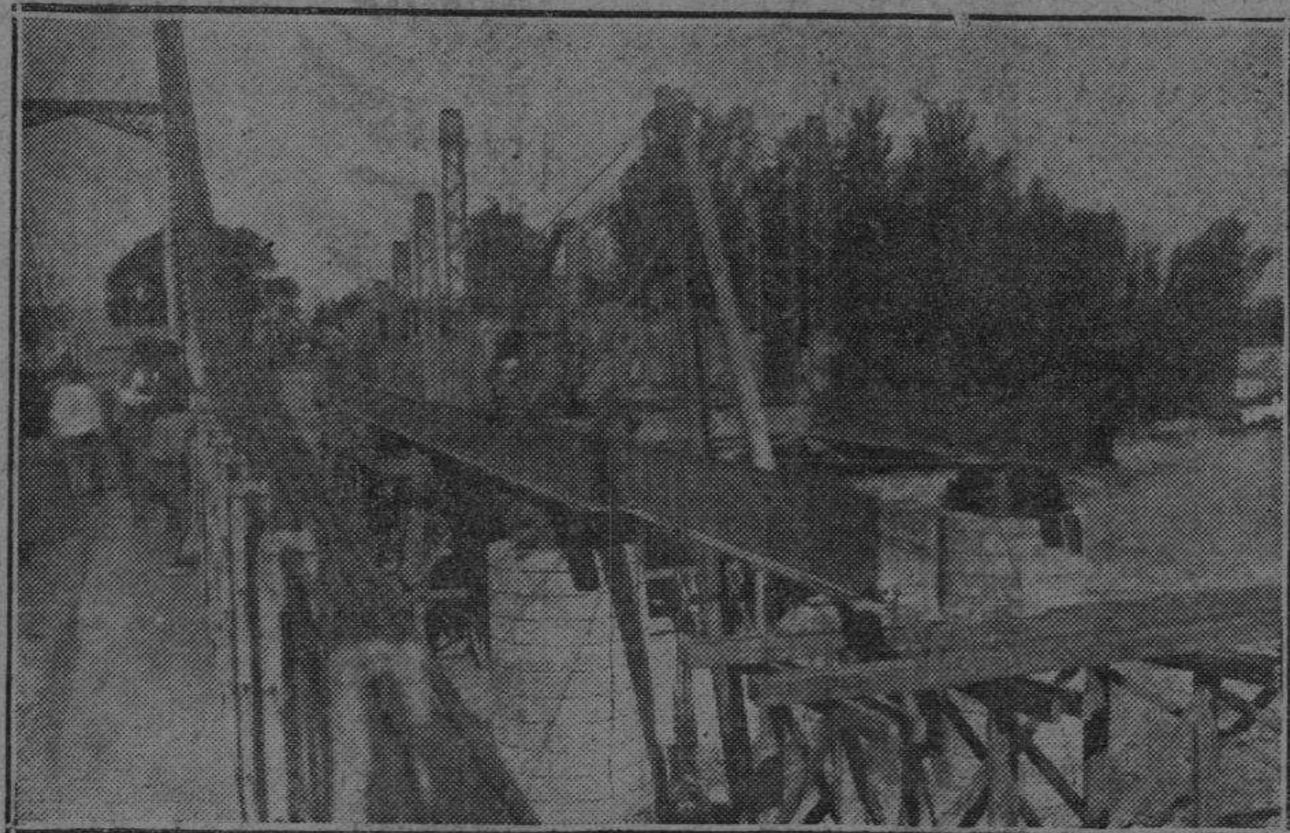
ZARAGOZA.—Construcción del nuevo puente metálico sobre el Gállego, junto al colgante, que ha de desaparecer. (Foto Pablos-Lizabe)
